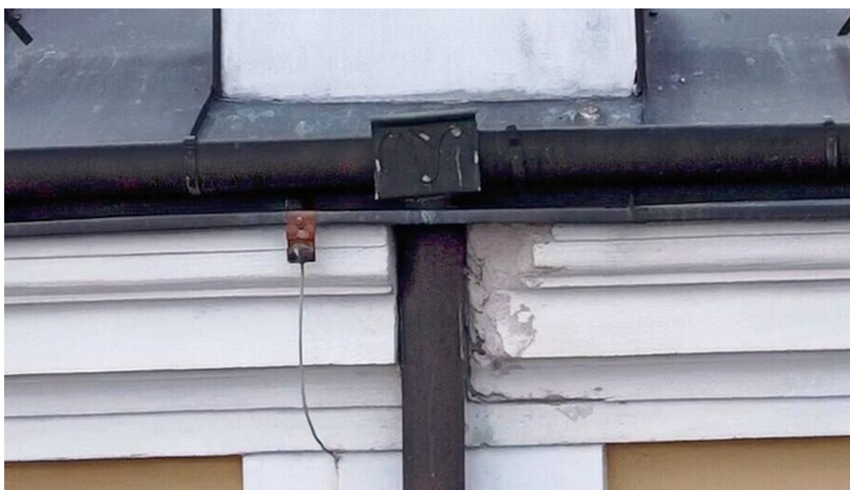
Fot. 2. Uszkodzenia gzymsu wieńczącego pod rynną na elewacji wschodniej.
