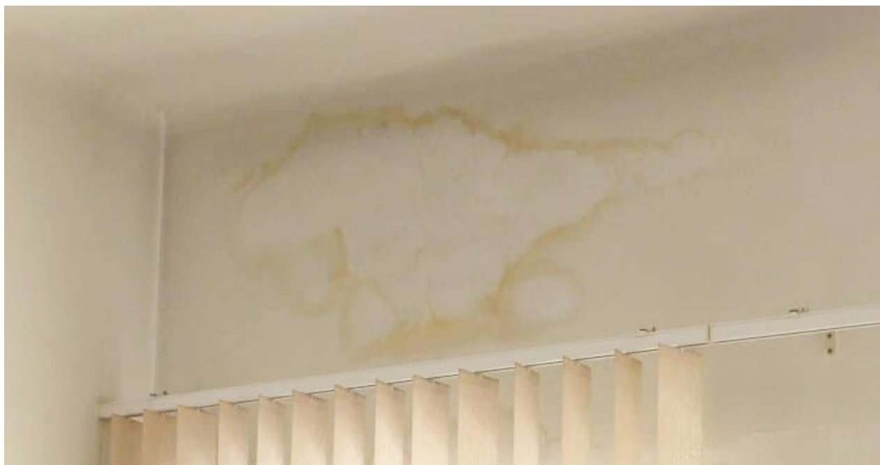
Fot. 8. Zacieki w jednym z pomieszczeń na piętrze w trakcie południowym.
