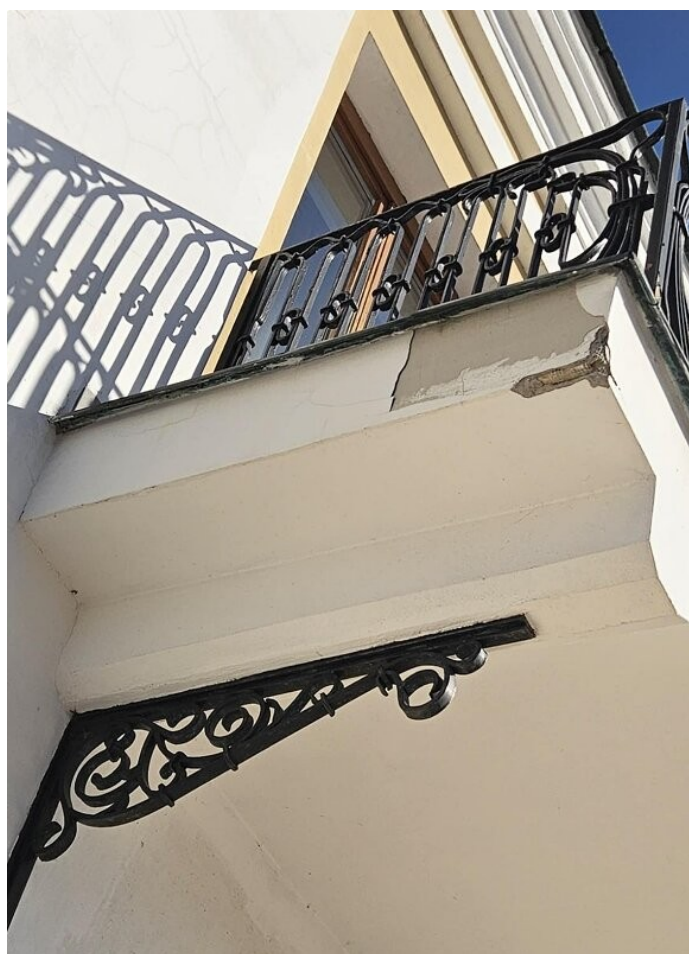
Fot. 7. Uszkodzenie mechaniczne narożnika płyty jednego z balkonów na elewacji południowej.
