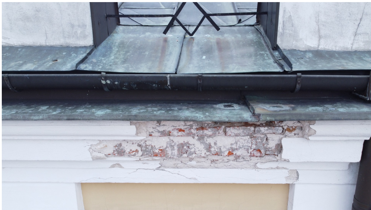
Fot. 1. Uszkodzenia gzymsu wieńczącego oraz nieszczelność pokrycia dachu na okapie na elewacji południowej.
