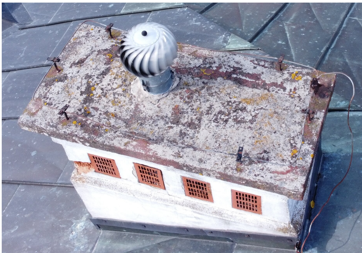
Fot. 5. Uszkodzenie trzonu oraz naloty i glony na czapie jednego z kominów.
