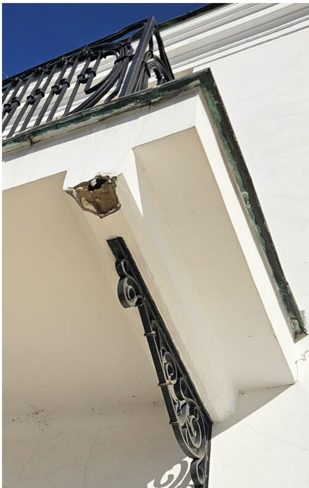
Fot. 6. Uszkodzenie mechaniczne belki pod jednym z balkonów na elewacji południowej.
