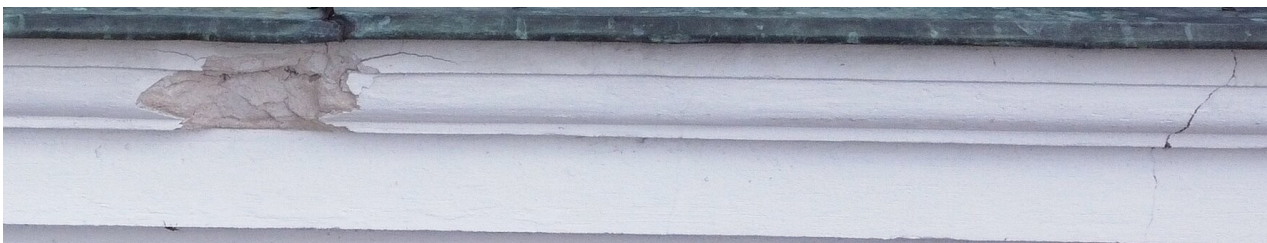
Fot. 3, 4. Uszkodzenia gzymsu wieńczącego na elewacji południowej
